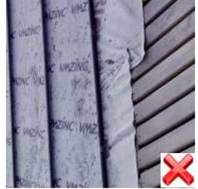
Örtü, havalandırma kesitini engelliyor.
